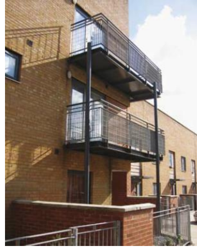
شكل (٩) انفصال شكل الشرفة عن المبنى
