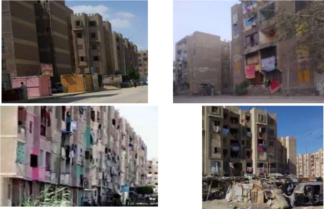
٥- جانب من بعض المساكن التي انشأتها الدولة وقد حدث بها تشوها بصريا نتيجة قاطنيتها بسبب استخدام الالوان عشوائيا
