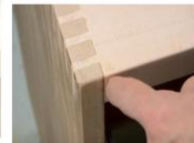
الصورة رقم (٩) توضح الشق
