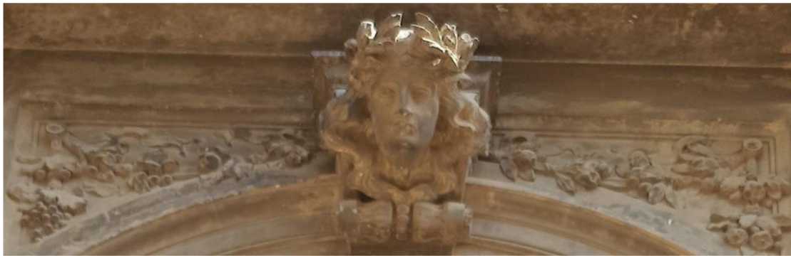
(٦١) تفاصيل وقناع لرأس آدمي لامرأة متوج بأكليل الغار تزين المشبك الأيوني ويحيط بكوشتي العقد أكليل الزهور وعناقيد العنب وأوراق الغار في الواجهة الشمالية الرئيسية "تصوير الباحث"
